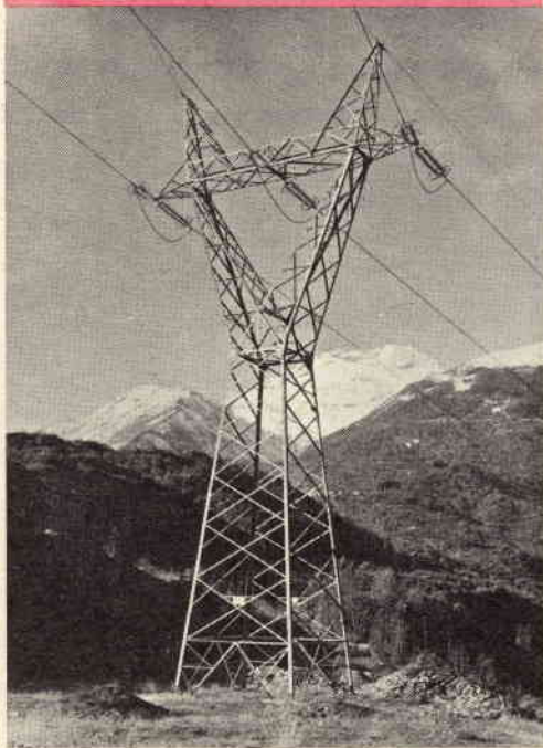
Palo in ferro, a traliccio, tipo a Y della linea a 220 kV Venauis-Torino (SIP); nella foto sono visibili due funi di guardia installate sulla sommità.
